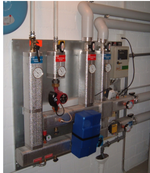
Unterstation eines Einfamilienhauses
