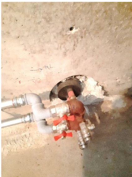
Bild 1: Die Hauseinführungs-Installationen brauchen nur sehr wenig Platz
