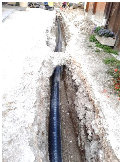
Bild 2: Die Anschlussleitung konnte an bestehende Leitung, welche bis an die Parzellengrenze verlegt war, angeschlossen werden und wurde für allfällige spätere Anschlüsse bewusst überdimensioniert ausgeführt.
