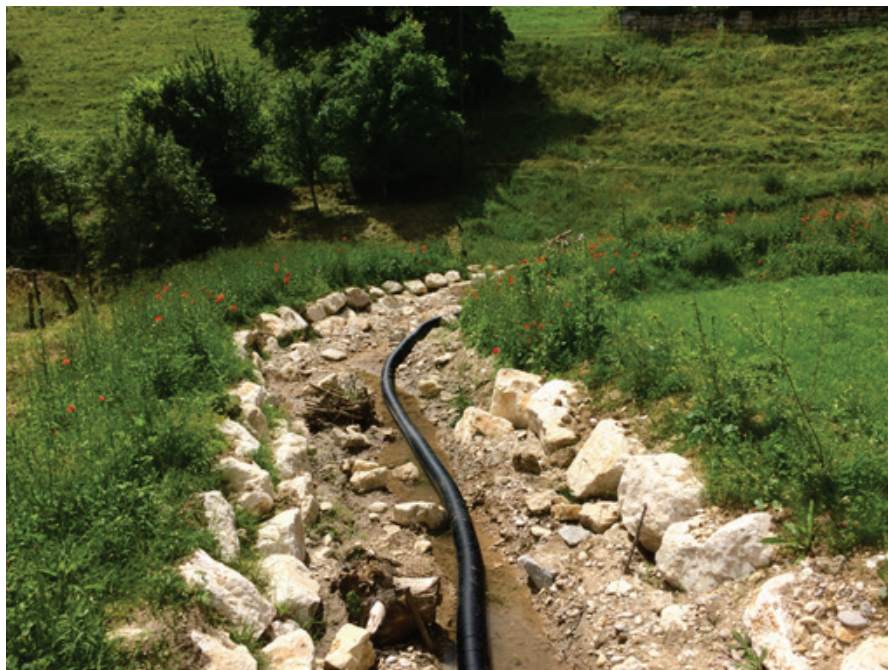
Dittingerbach nach Abschluss der Bauarbeiten (Juni 2018) Fotos und Text: Jonas Woermann, Projektleiter Gewässerplanung Kanton
